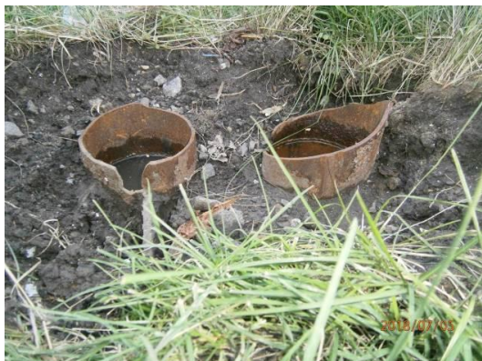
Рисунок 1. Місце руйнування рекламної конструкції
